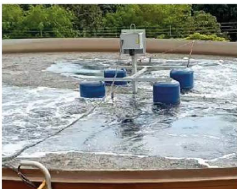
Aerador Tornado Biturbo Rotativo em tanque
