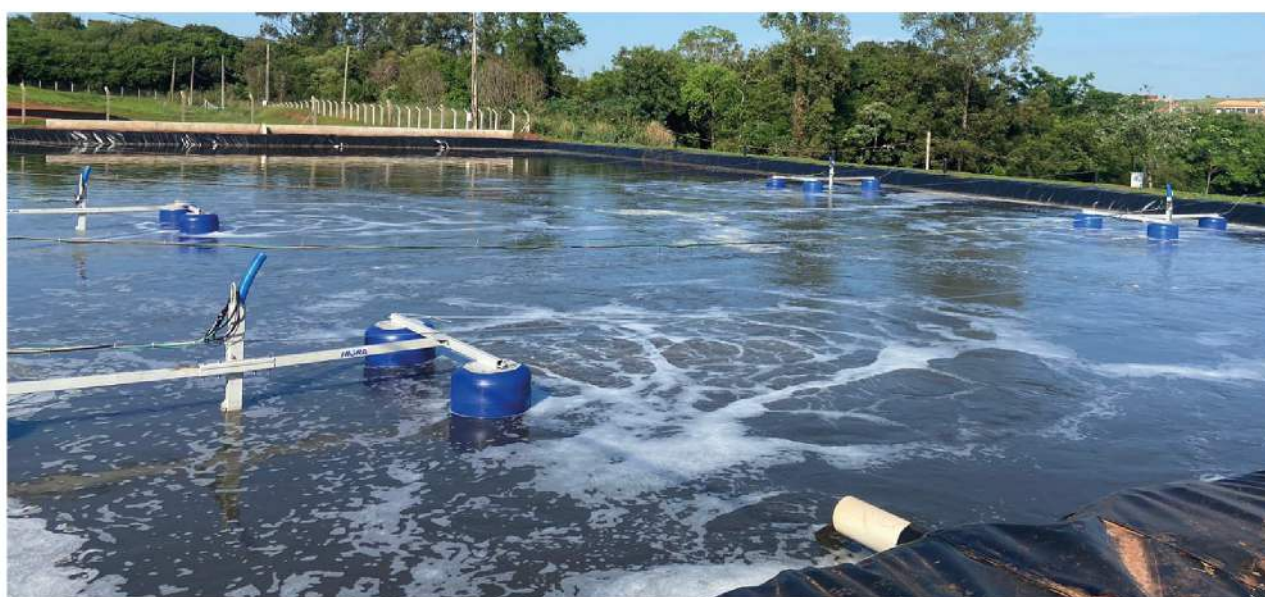
Aeradores Tornado operando em lagoa de tratamento
