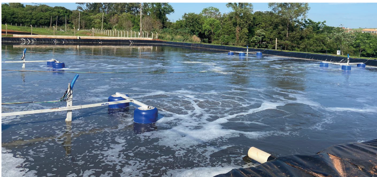
Aeradores Tornado operando em lagoa de tratamento
