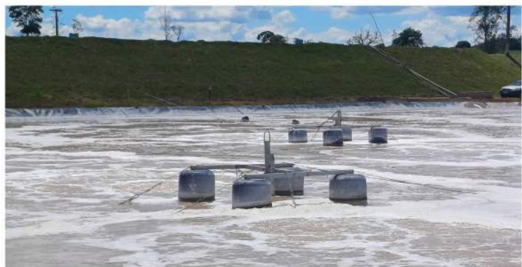
Aerador Tornado Biturbo em indústria Laticínios
