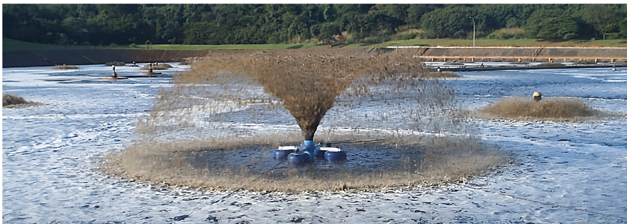
Aerador Submerso Propulsor em sistema de tratamento de efluentes
